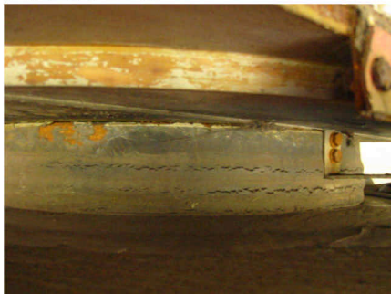
RISSE IM LAGER
